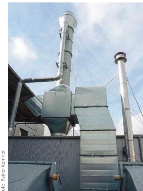
Der Kreuzluftwärmetauscher der Lackierung gewinnt knapp 50 % der Wärmeenergie aus der Abluft zurück.
