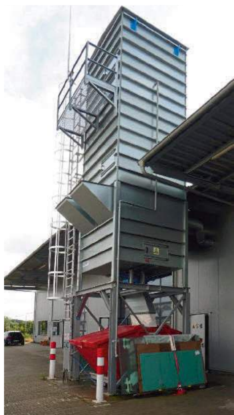
Besonders ist die untergebaute Zellenradschleuse, die die Mulde drucklos mit Staub und Spänen füllt.
