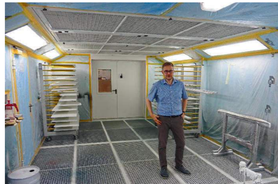
Der 40-m 2 -große Lackiercontainer ist mit einer Unterflurabsaugung und Filterung sowie mit einer großen Zuluftdecke ausgestattet, die exakt die Luftmenge zuführt, die unten abgesaugt wird.
