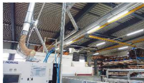
Die LED-Beleuchtung wurde so geplant, dass sie an den nötigen Stellen gezielt für gute Ausleuchtung sorgt.
