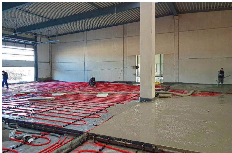
Im Unterschied zur Fußbodenheizung werden die Heizschlangen der Betonkernaktivierung nicht mit einer dünnen Estrichschicht, sondern mit 24 cm Beton überdeckt, sodass überall problemlos Maschinen aufgestellt werden können.
