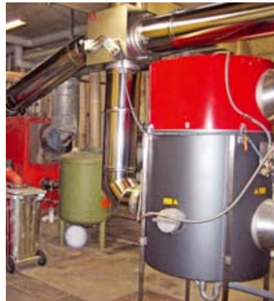
/ Aufstellungsbeispiel für eine automatisch beschickte Holzfeuerungsanlage in Kombination mit einem elektrostatischen Abscheider (Nolting, Schröder, Kraft)
